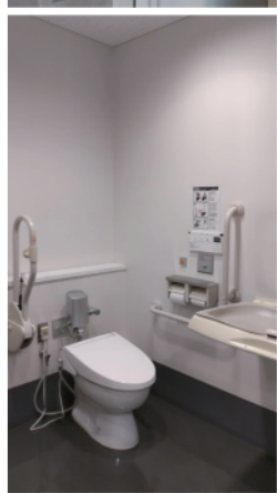
市民と共にトイレのバリアフリーを徹して、「誰でもトイレ」を提案。公共施設に増設することができた。
